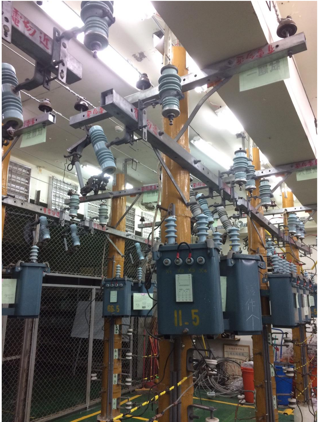
聖約翰科大 電機系 室內配線 實習工廠 第三站 圖四
