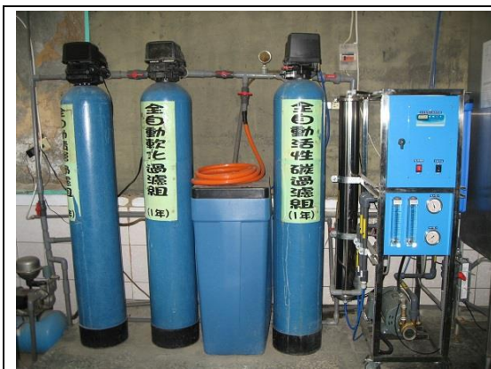
(a) 逆滲透設備
