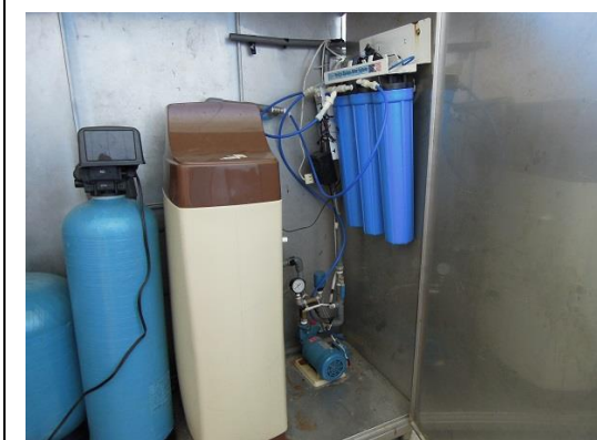
(c) 中型逆滲透設備
